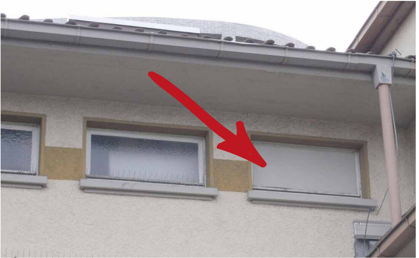
Fenster seit dem Sturm Lothar 1999 mit Brettern verschlossen
